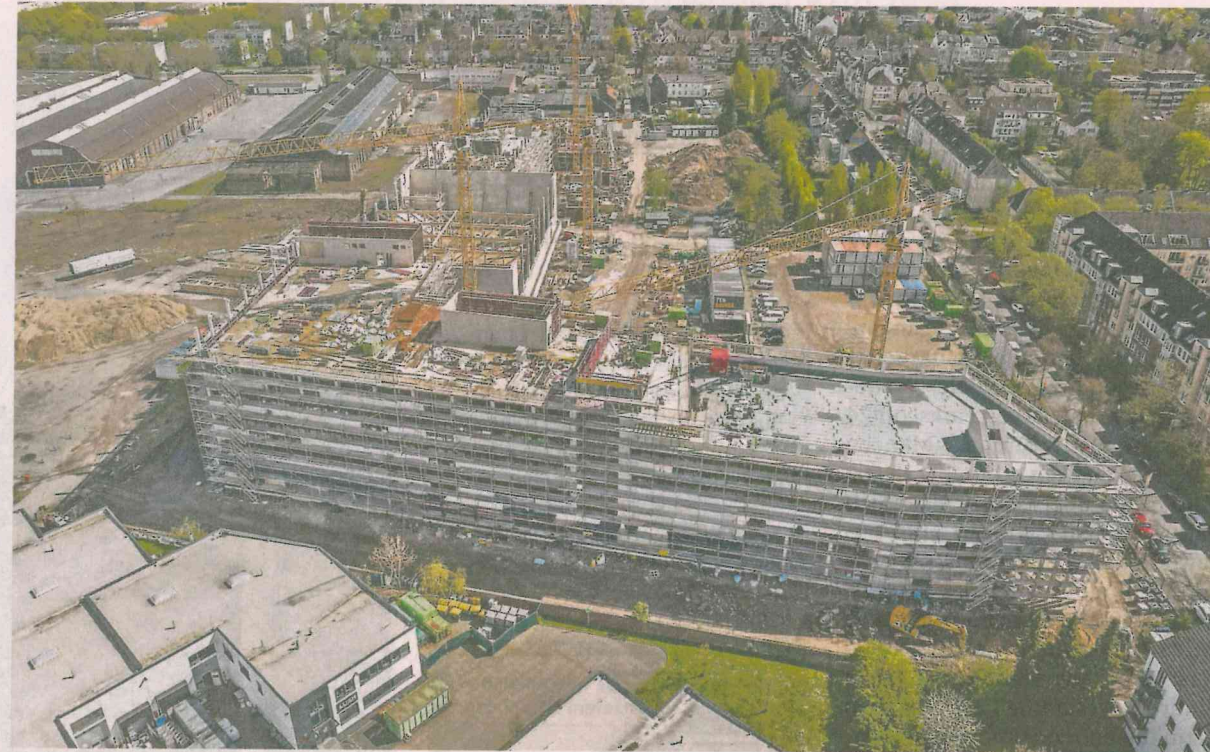
Blick von oben auf die Baustelle: Der vordere Komplex ist das Benrather Schloß-Gymnasium, an das sich die neue Vierfachsporthalle anschließt.
