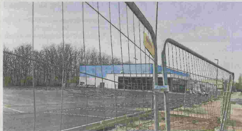
Der Parkplatz an der Eishalle Kappeler Straße ist seit Ende Januar fertig gestellt, wartet aber noch auf die Freigabe.
